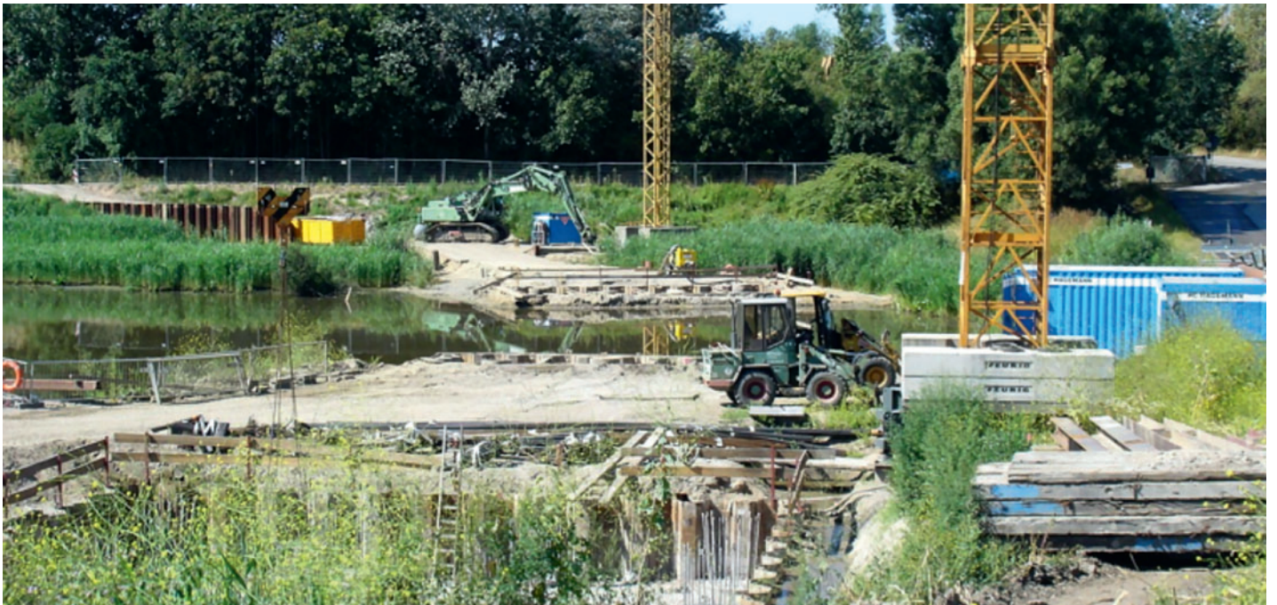
Das Bild zeigt die Baustelle der zukünftigen Brücke über die Alte Süderelbe im östlichen Teil der Umgehungsstraße.
